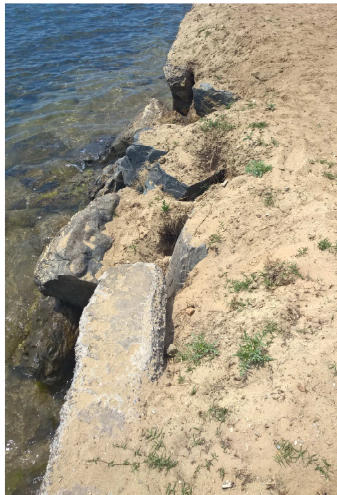
Figure 2-17 : Visualisation de glissement de sables depuis le chemin (visite technique B. Waeles du 15/06/2017).
