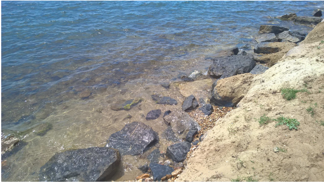
Figure 2-16 : Visualisation de glissement de sables depuis le chemin (visite technique B. Waeles du 15/06/2017).
