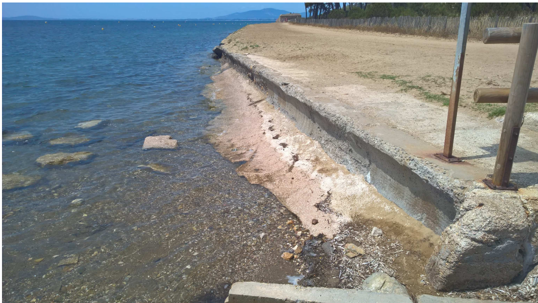
Figure 2-13 : Photo (B. Waeles, visite technique du 15/06/2017), devant le débouché prévu dans le cadre du projet d'aménagement hydraulique, montrant l'ouvrage en dur définissant le trait de côte et des fonds très inhomogènes (sables, graviers, galets, blocs).
